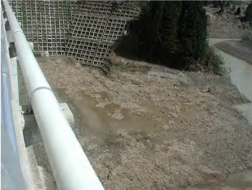
【写真6】 堤体の裏の堆積物の様子
