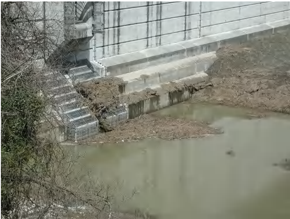
【写真7】 穴あきダムへのスクリーンに堆積した植物残滓
